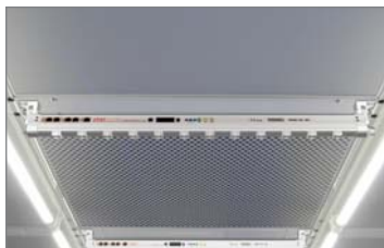
クリーンルーム天井
